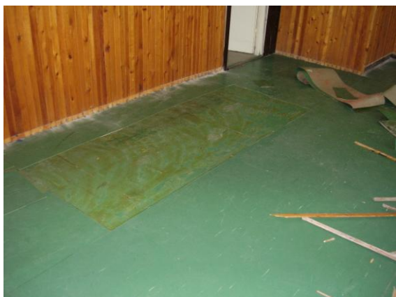
Régi informatika tanterem PVC burkolata a felújítás előtt
