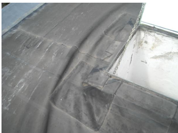
Tetőkibúvó régi szegélye a felújítás előtt
